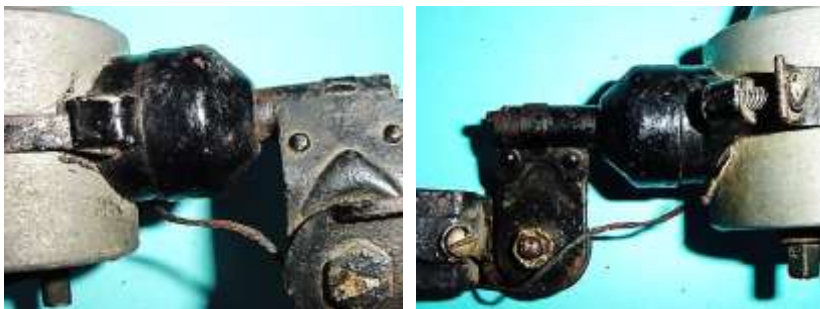
Bild 4.18: Massekabel zwischen Spannbandverschluss und Masseschraube
